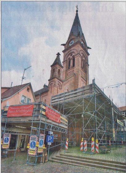
Ein riesiges Sicherungsgerüst um die katholische Kirche St. Johannes Nepomuk am Marktplatz soll herabfallende Teile der Sandsteinfassade auffangen. Foto: Alex
