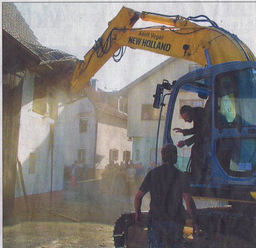
Nah der Ortsmitte sollen 23 betreute Seniorenwohnungen entstehen; OB Albrecht selbst übernahm gestern den Baggerbiss zum Abruch eines Gebäudes in der Neuen Straße. Fotos: Heß
