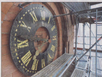
In luftiger Höhe auf der eingerüsteten Baustelle: eines der insgesamt vier Zifferblätter der Turmuhr. Foto: Slogisnat
